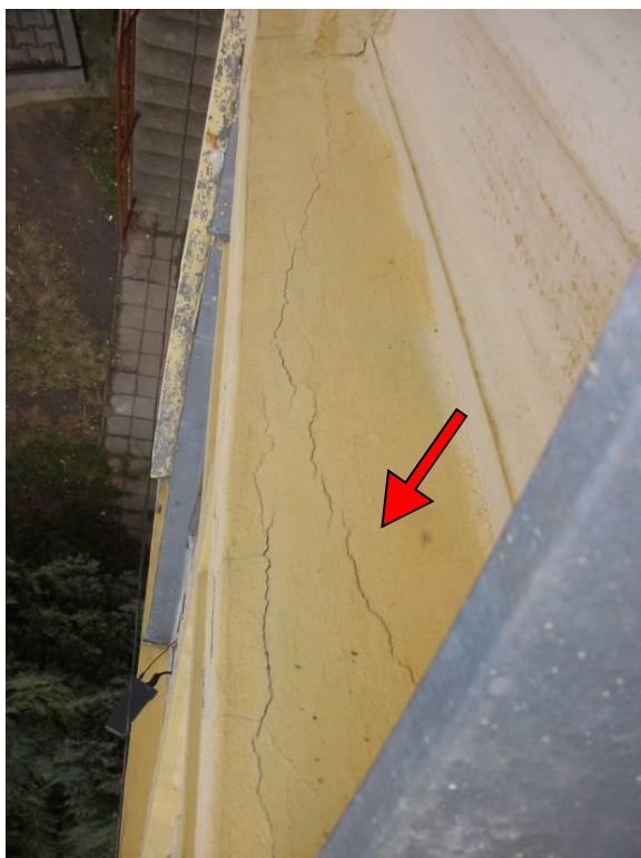
Obrázek 16.: Detail trhliny na severní fasádě (šipka). Beton odpadává.
