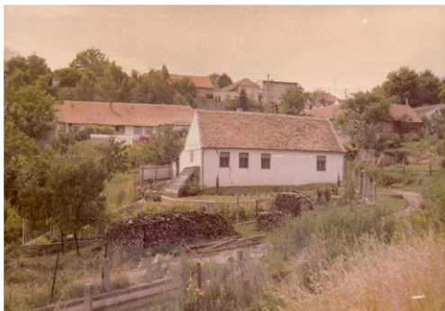
Obrázek 7.: Rodinný dům na sesuvném svahu – zvětšené trhliny na levém rohu.
