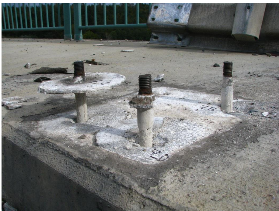
Obrázek 2.: Pohled na kotevní šrouby mostního svodidla po provedení osové zatěžovací zkoušky, v tomto případě nebylo dosaženo požadované únosnosti.
