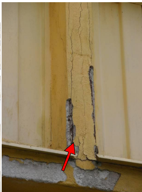
Obrázek 21.: Styk panelů podélné jižní fasády. Koroze výztuže, beton ve velkých kusech odpadá.
