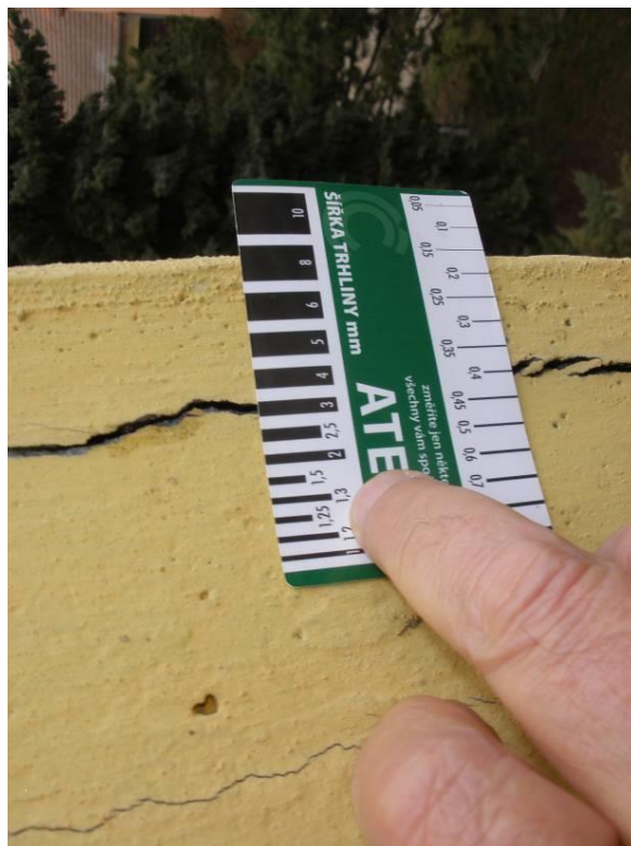
Obrázek 17.: Detail trhliny na severní fasádě. Beton lze snadno odstranit.
