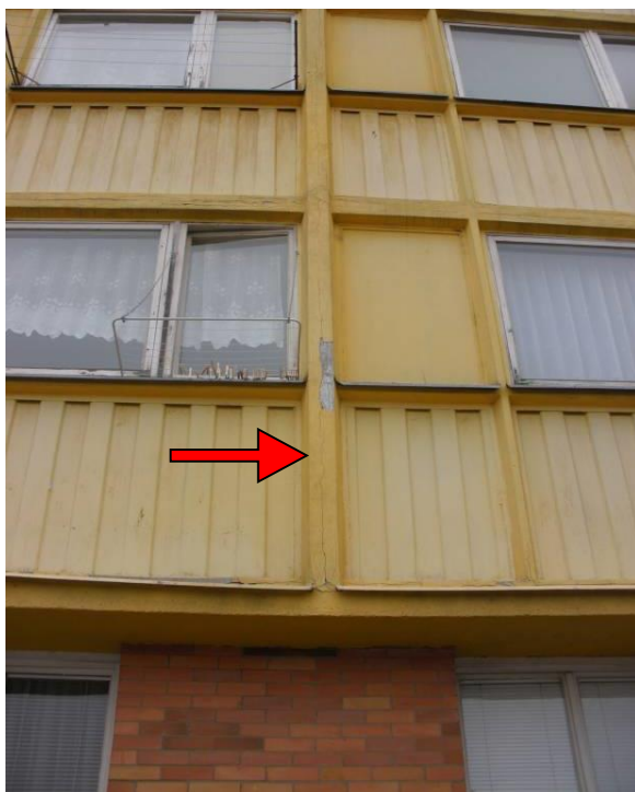
Obrázek 18.: Praskliny ve styku zavěšených panelů na severní fasádě.
