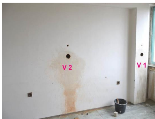
Obrázek 4.: Zkušební místa pro odběr vzorků V1, V2 v příčné stěně v rohové místnosti ve 3.NP. objektu v bytě.
