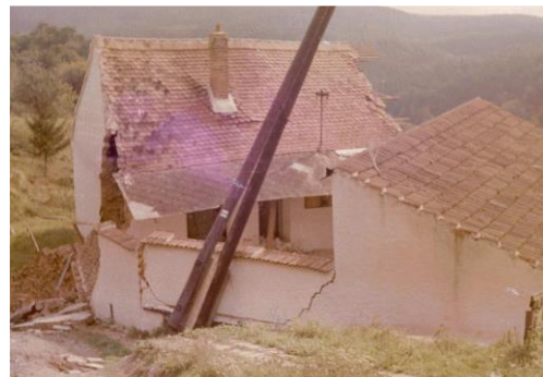
Obrázek 8.: SZ pohled na rodinný dům, porušená cesta, nakloněný sloup elektrického vedení.
