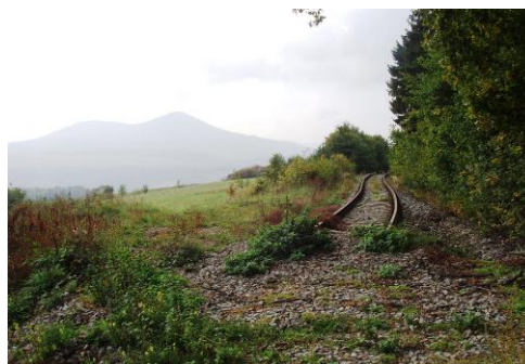
Obrázek 6.: Poškození železniční trati na sesuvu (internet).
