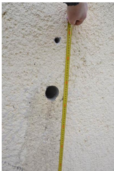
Obrázek 14.: Vývrt V 3 do obvodového panelu na jižní straně domu.
