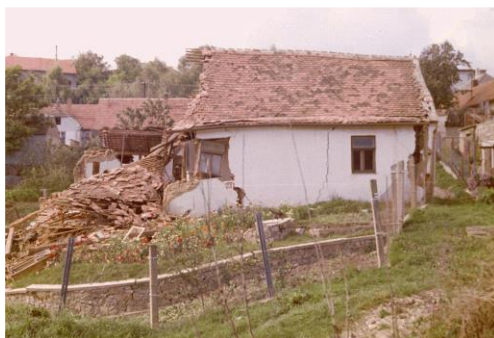
Obr. 9.: Zřícení jižní části domu, všeobecné potrhání.
