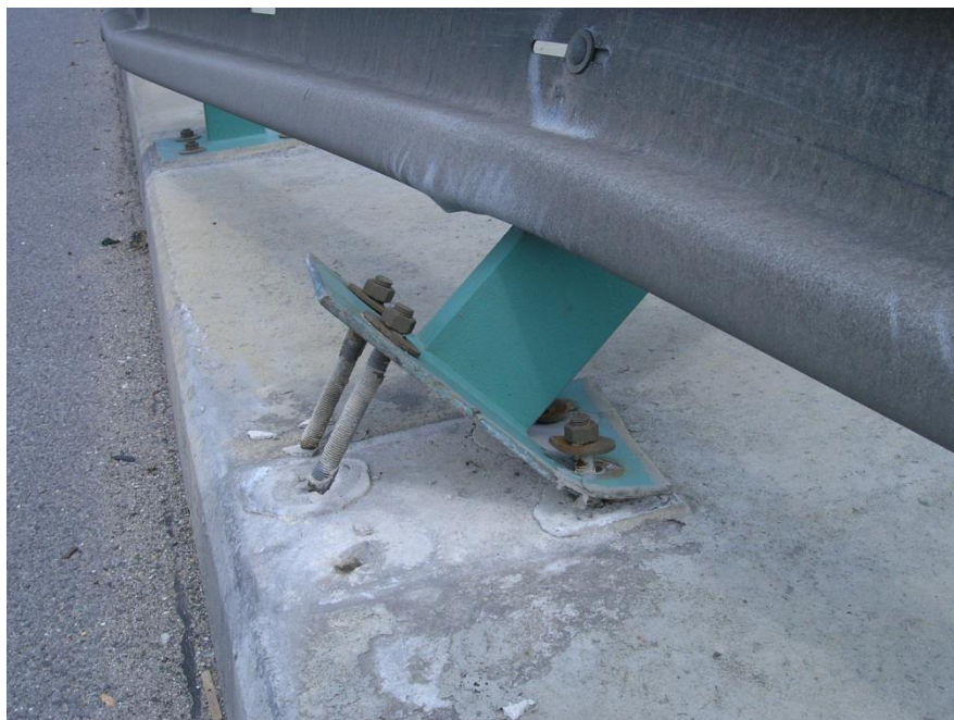
Obrázek 1.: Pohled na sloupek silničního svodidla na mostní konstrukci po čelním nárazu osobního automobilu
