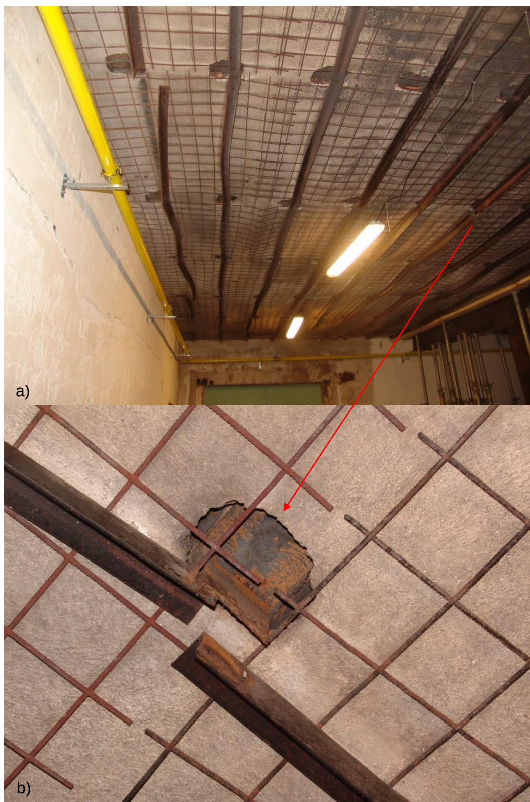
Obrázek 2.: Stropní konstrukce nad 1. NP (sanace proběhla již před požárem); a) pohled; b) detail kotvení prvků nosoucích kari sítě pro zachycení dříve porušeného hrdiskového stropu
