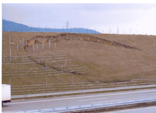
Obrázek 11.: Počáteční sesuv svahu dálnice.
