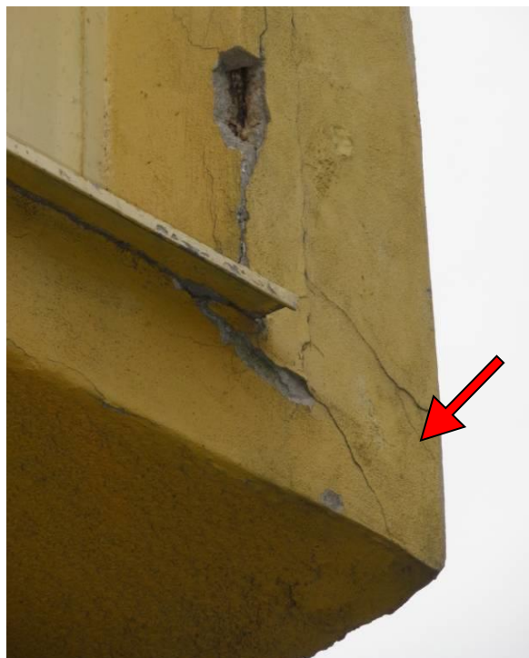
Obrázek 19.: Potrhaný roh na severní a západní fasády (šipka). Styk panelů.
