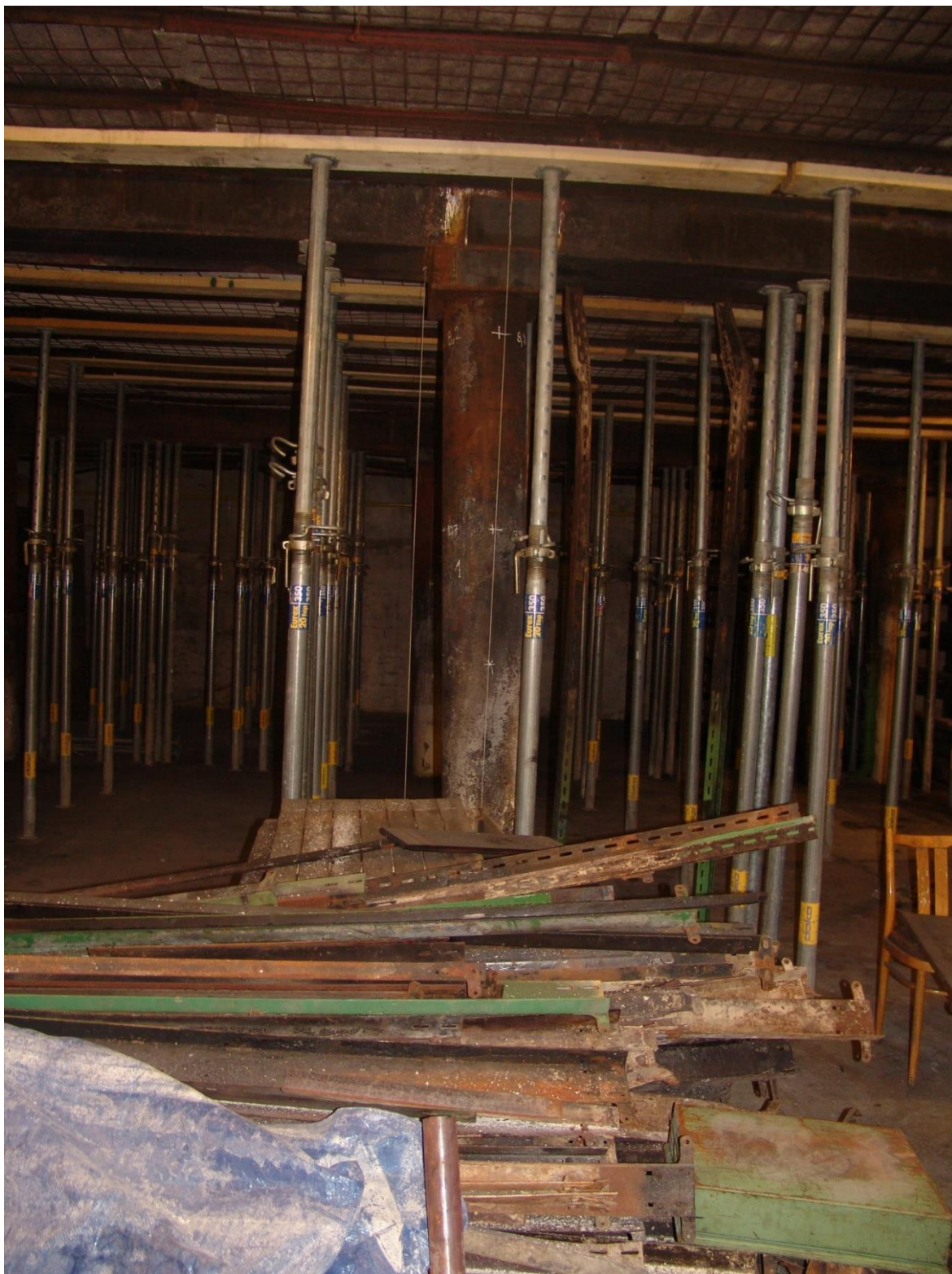
Obrázek 1.: Svislá nosná konstrukce v 1. NP a pohled na provizorní statické zajištění, pohled na hodnocenou stropní konstrukci nad 1. NP
