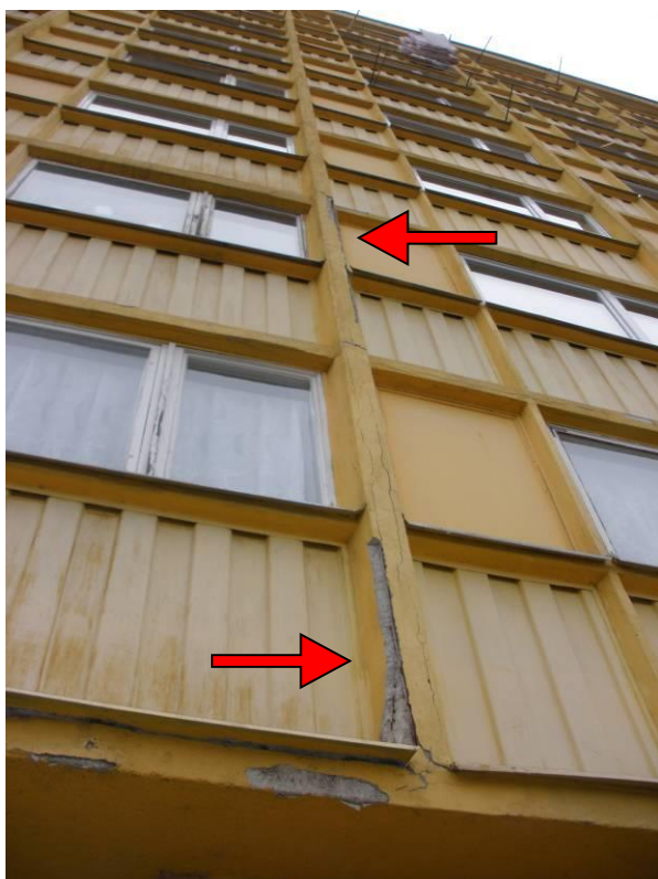
Obrázek 20.: Další trhlina (šipka) s korodující výztuží a odpadávajícím betonem (jižní fasáda) ↑
