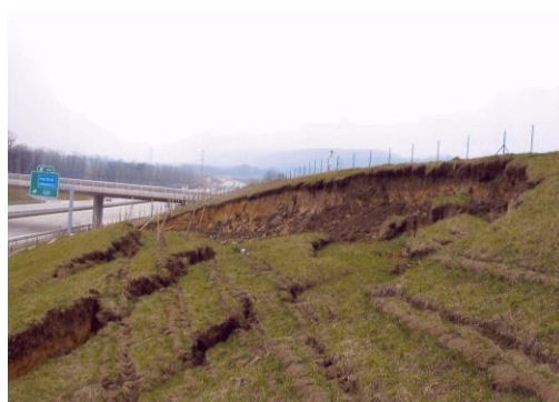
Obrázek 12.: Stav sesuvu po dvou týdnech po jeho vzniku.
